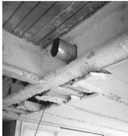
Spritzasbest an einer metallischen Tragkonstruktion.
