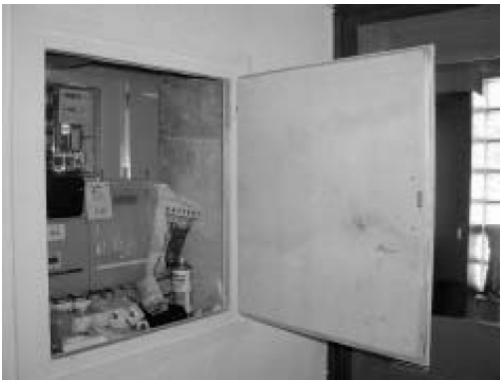
Sicherungskasten mit asbesthaltiger Brandschutzplatte an der Innenseite der Tür.
