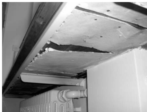
Frei zugängliche Asbestpappe an Fensterbrettuntersichten.
