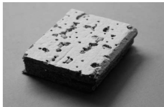
Teil einer asbesthaltigen Akustikplatte.
