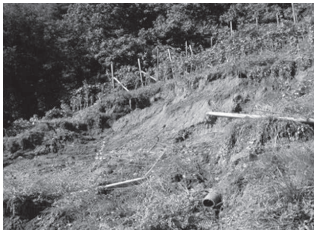
Murabbruch in einem Weinberg
