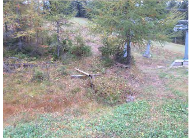
Wasseraustritt seitlich der Talstation
