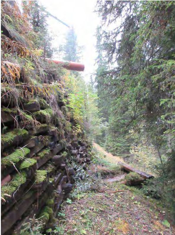
Rohrleitung mit Wasserabfluss talseitig der Stützstruktur der Talstation
