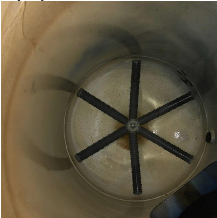
Foto gereinigter Aktivkohletank – Kunststoffrohre im Bodenbereich
