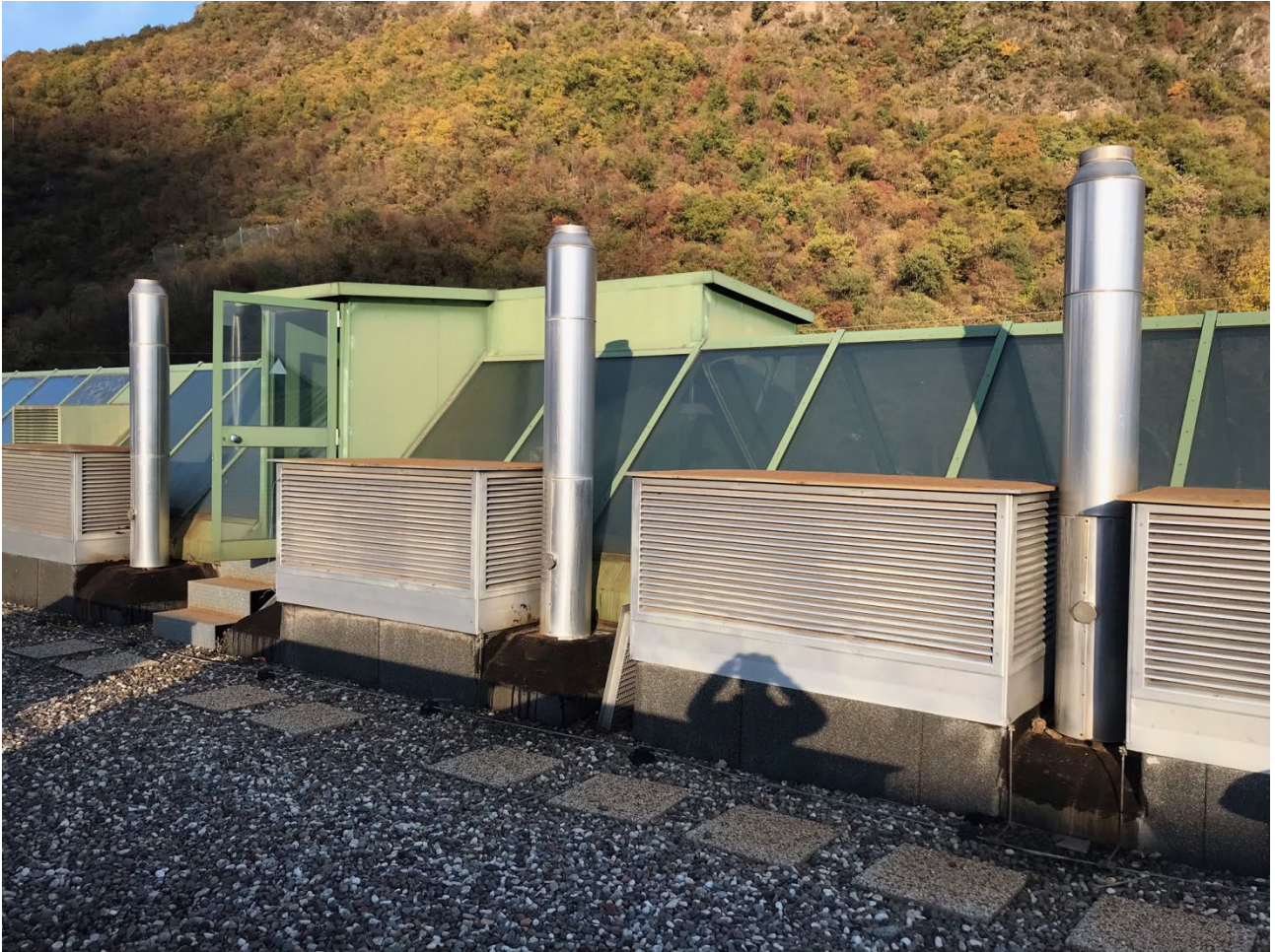
Foto dei tre camini esistenti sulla copertura del locale cogeneratori
