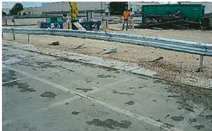
Plasticizzazione alla base dei montanti
