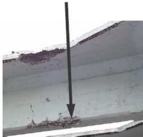
Betonschäden durch LKW - Anprall
