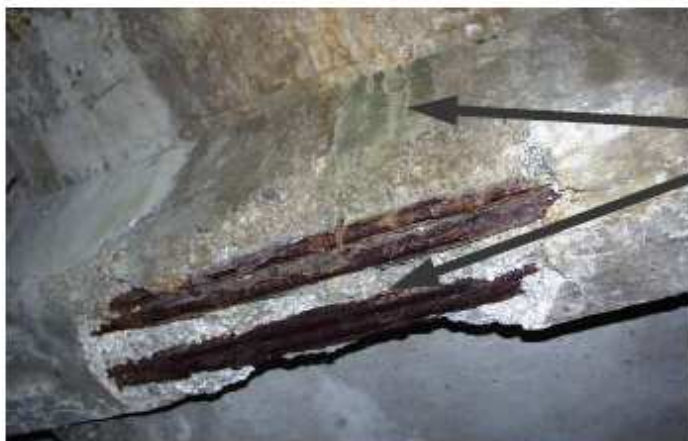
die Durchfeuchtung verursachte die Korrosion an der Bewehrung und in der Folge die Ablatzung der Betondeckung
