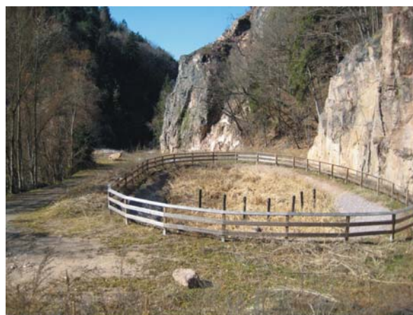
Pflanzenkläranlage Hohlen Impianto di fitodepurazione Olmi
