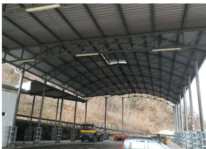
Figura 4. Luogo d'installazione del prototipo sperimentale HTC al di sotto della tettoia.
