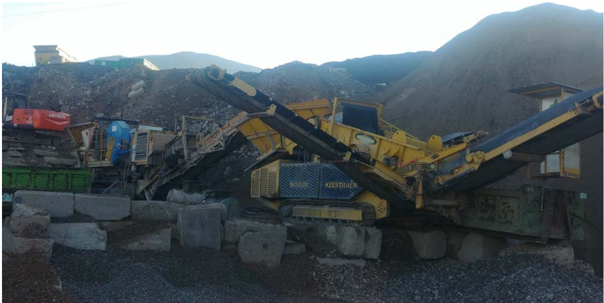
Abbildung 8: Brecher und Siebanlage am Gelände der P.R.A bei Bruneck
