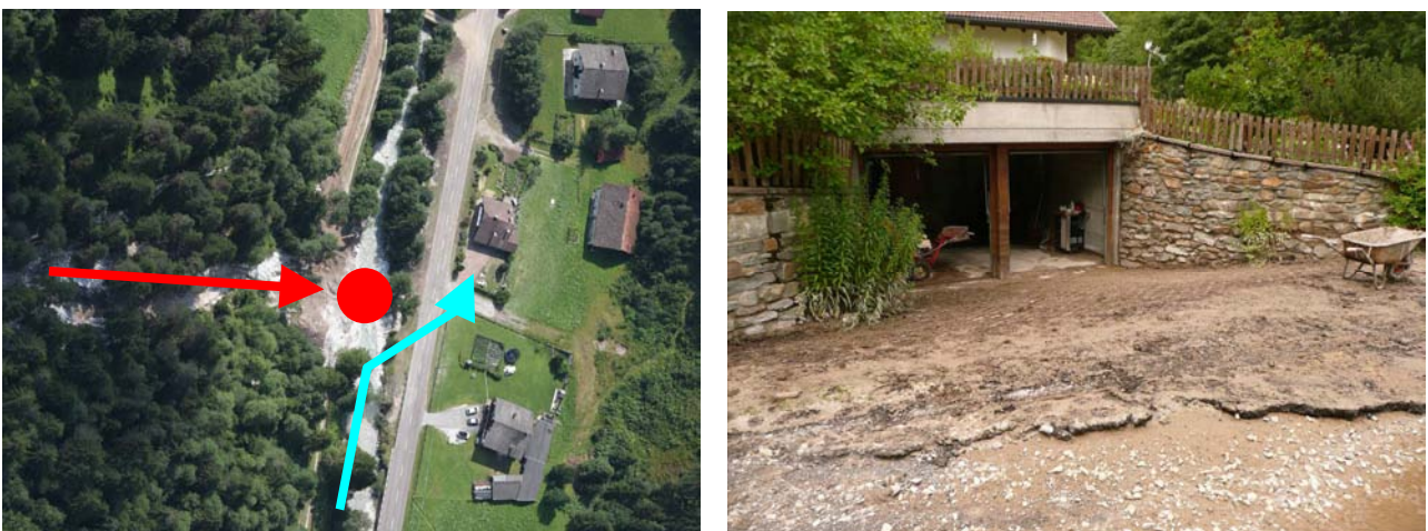
L'occlusione e la conseguente esondazione del Rio di Fleres ha provocato danni all'abitazione adiacente
